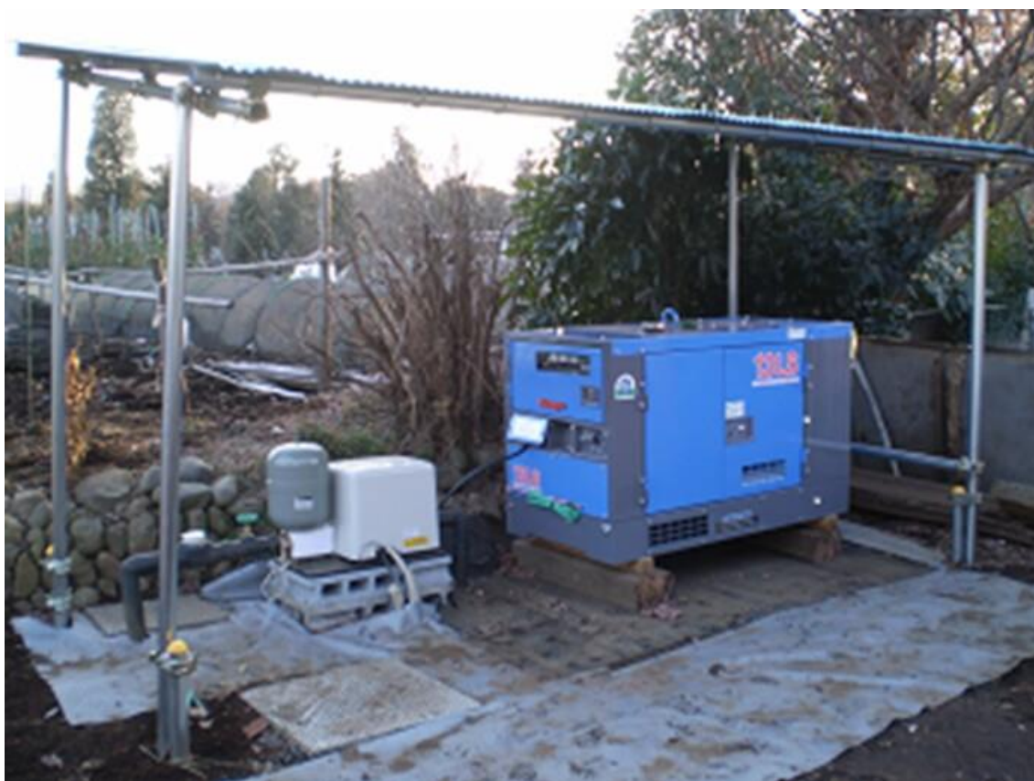
国分寺市の電動式井戸（停電時には非常用発電機を使用し井戸水を汲み上げる）
